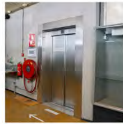
liften recent vervangen; nieuwe deuren en kozijn stordend aanwezig
