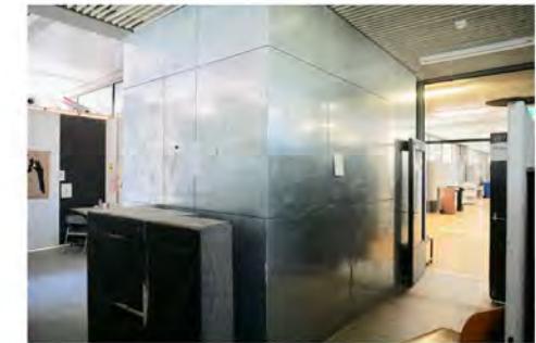
metalen doos tbv nieuwe luchtbehandelingsinstallatie (sinds 2003)
