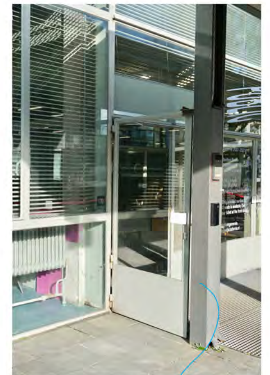
er zijn diverse zaken bevestigd aan de kolommen bij de entree; hier is zelfs het H-profiel opgevuld
