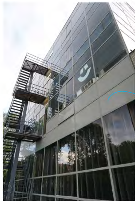
de pui is plaatselijk geblinddeerd
