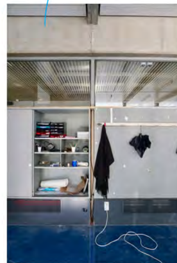
hier recent een pui verwijderd; duidelijke sporen hiervan vragen verkeerd soort aandacht (nb. deze wand aangegeven als schuifpui; evt. nader bekijken)
