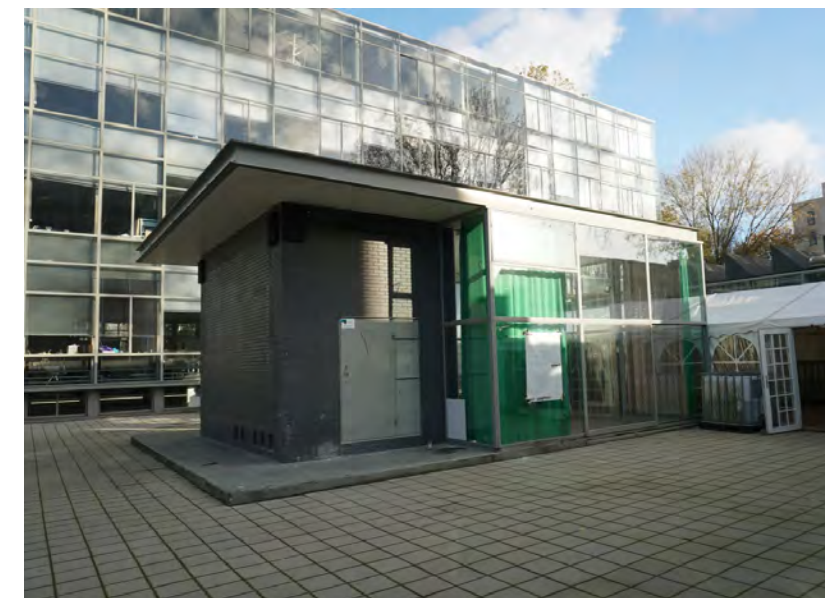
door het dichtzetten van de overdekte buitenwerkplaats is de verbinding van deze luifel met die van de entree verzwakt; de aansluiting van de pui op het dak komt niet voor in het originele gebouw.
