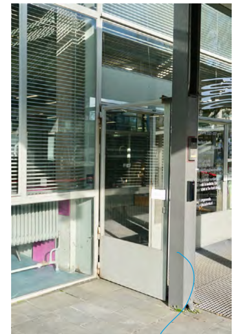
er zijn diverse zaken bevestigd aan de kolommen bij de entree; hier is zelfs het H-profiel opgevuld
