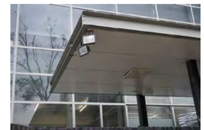
originele entreeluifel; ook plafond en lichtarmaturen origineel (luifel van buitenwerkplaats heeft hetzelfde randdetail)
