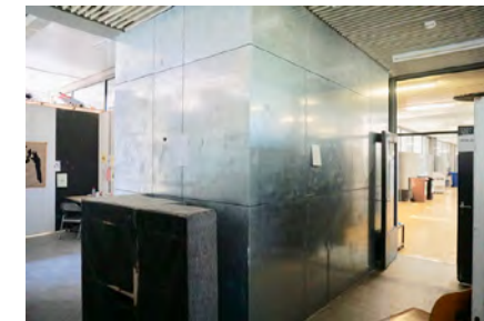
metalen doos tbv nieuwe luchtbehandelingsinstallatie (sinds 2003)
