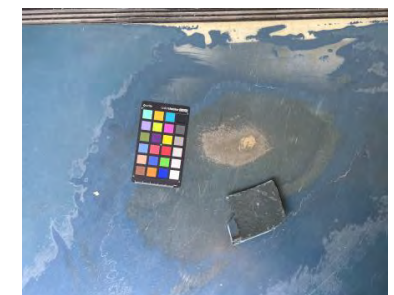
Fig. III.2.8: De opbouw van de verschillende vloerafwerkingen in verschillende blauwtinten is goed zichtbaar in beschadigingen van de vloer. Witte vullingen die bij de restauratie werden aangebracht zijn nu zichtbaar.
