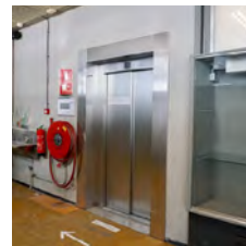
liften recent vervangen; nieuwe deuren en kozijn storend aanwezig
