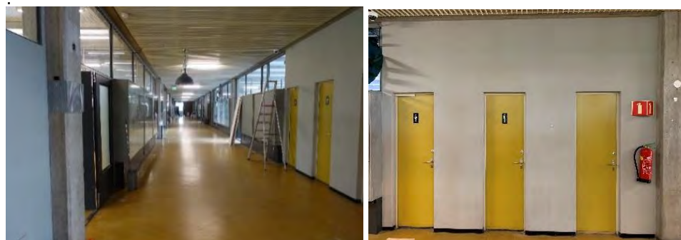
eerste verdieping met lichtgrijze wand met donkergele deuren in witgrijze stalen kozijnen naar de toiletten (deur rechts is nu een pantry, 2003-4).
