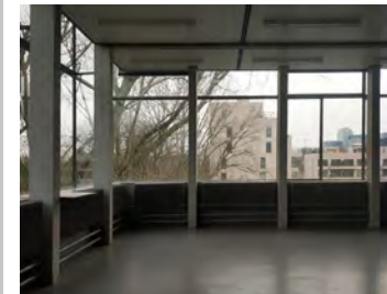
68. Radiatoren langs de vliesgevel, foto WDJA
