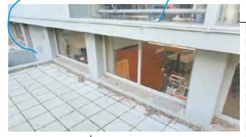
vensterbanken slordig bijgetegeld
