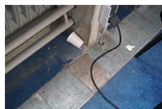
zeer zichtbare kabelgoot
